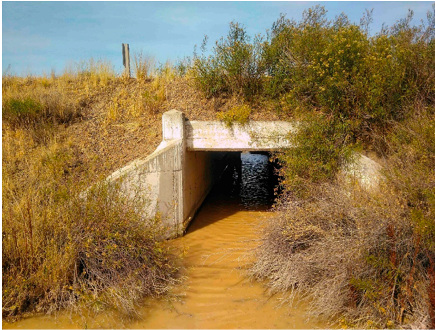
Foto 2. Alcantarilla donde fue hallado el nido en la provincia del Chubut.
