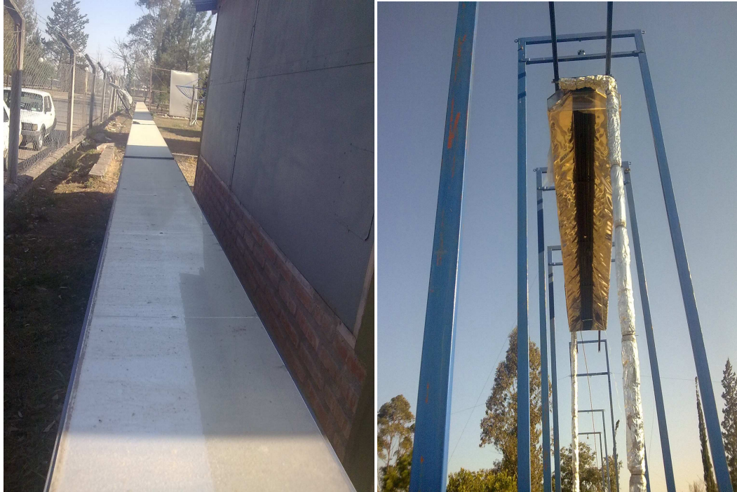
Figura 1: Espejo de 50 metros montado sobre un eje. Figura 2: Absorbedor y concentrador secundario elevados.
