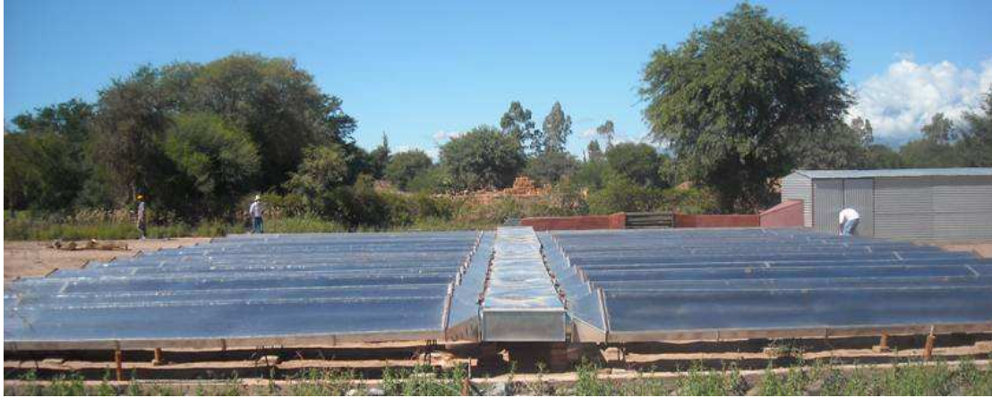
Figura 1: Campo de colectores, ductos, intercambiador de calor y cámara de secado
