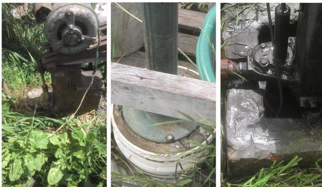
Figura 3. Ejemplos de deficiencias constructivas en las perforaciones muestreadas, que favorecen el ingreso de posibles contaminantes al pozo.
