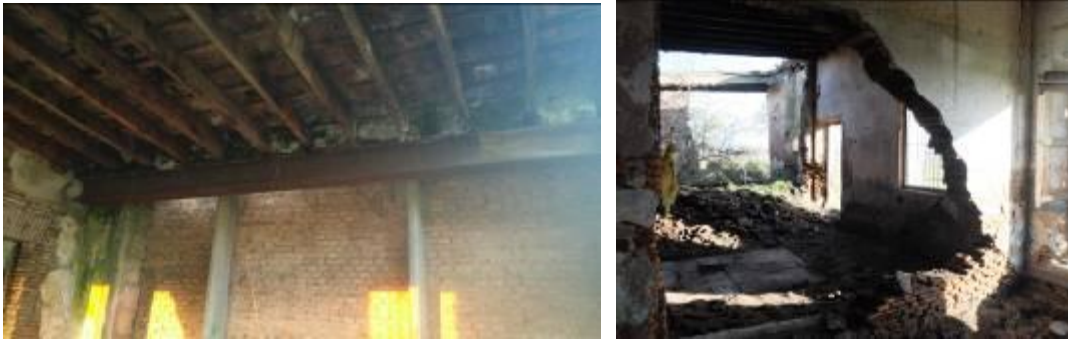
Figs. 48 y 49. Viga de acero y columnas de hormigón para sostener la cancha de pelota cuyos empujes destruyeron el sector, la pared muestra la transmisión de los esfuerzos.
