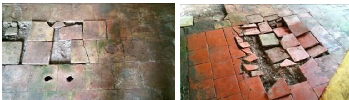
Figs. 36 y 37. Baldosas del Havre con agujeros intencionales, y parche hecho por baldosas de Marsella para cubrir un hundimiento relleno con tierra.
