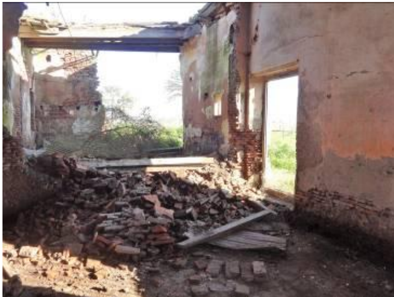
Fig. 50. Paredes caídas por no poder soportar los esfuerzos horizontales de la nueva estructura. Es lamentable ya que era el sector más antiguo.
