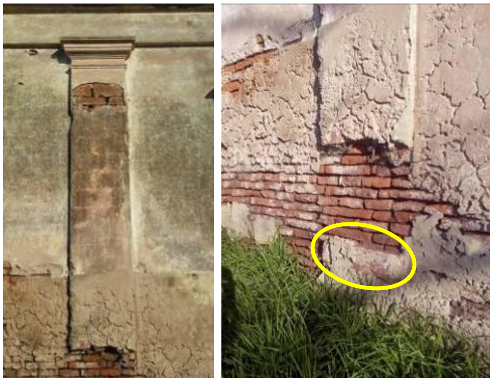
Figs. 40 y 41. Pilastras del lado Norte: nótese el uso de ladrillos en forma irregular y que no hay nada que las amarre a la pared que fue construida antes y sin ellas. En amarillo: revoque delgado puesto antes de que se hicieran las pilastras.
