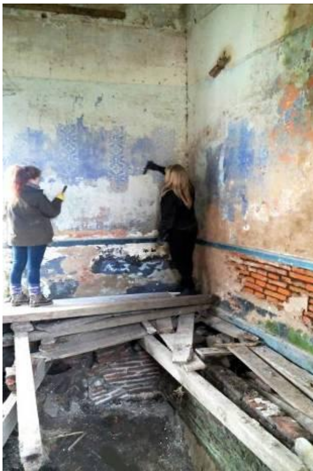
Fig. 1. Sótano y habitación derruidos del sector antiguo del edificio, que fuera usado en 1893-94 como Comandancia. Nótese los estarcidos de color azul mientras mientras son limpiados de las pinturas sobrepuestas 1 .
