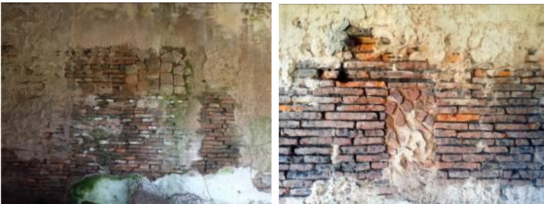
Figs. 58 y 59. Parches en los muros hechos con materiales del sitio pero en diferentes épocas.
