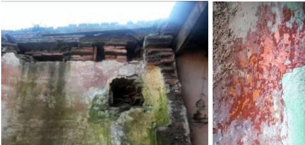
Figs. 45 y 46. Sistema de mechinales para las vigas originales y restos de estratos de pinturas de la casa más antigua, plenamente decorada.
