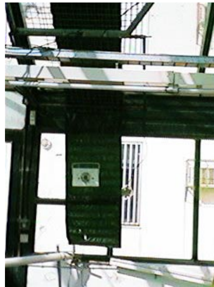
Figura 3. Foto del colector negro (Sur)
