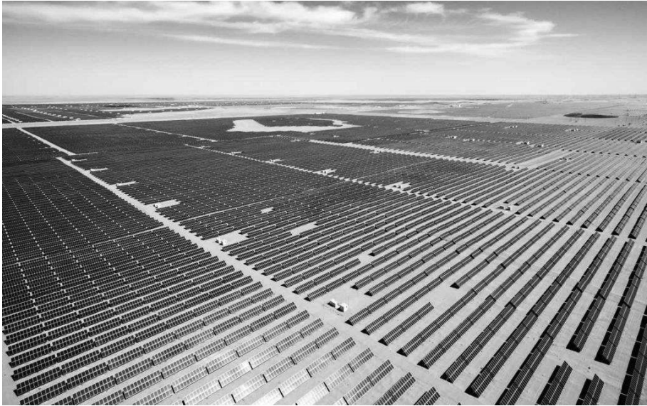
Photo 3b : Centrale photovoltaïque de Cauchari, province de Jujuy (Argentine) a
