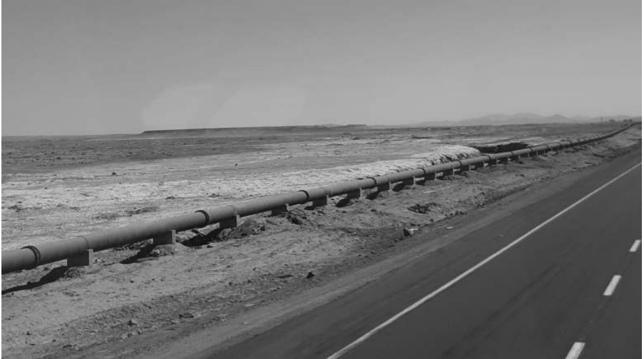
Photo 2b : Aqueduc transportant de l'eau douce depuis la côte pacifique vers les territoires miniers
