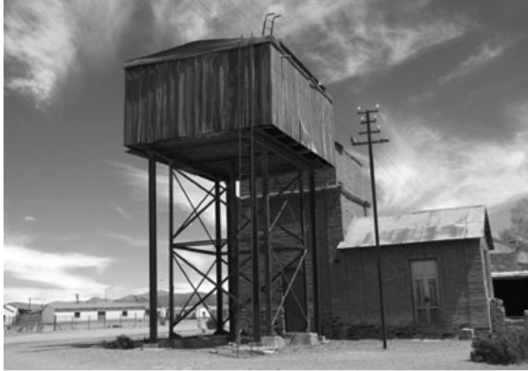
Figura 4: Tanque de agua prefabricado en perfiles de hierro, chapa y cobertura de madera para evitar el congelamiento. Situado en el Estación Tres Cruces sobre la línea Jujuy-La Quiaca. Fuente: Mónica Ferrari, 2009.
