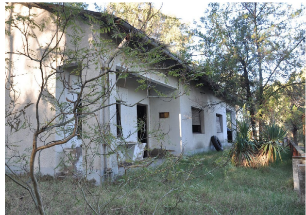
Figura 5. Algunas de las viviendas y construcciones abandonadas.
