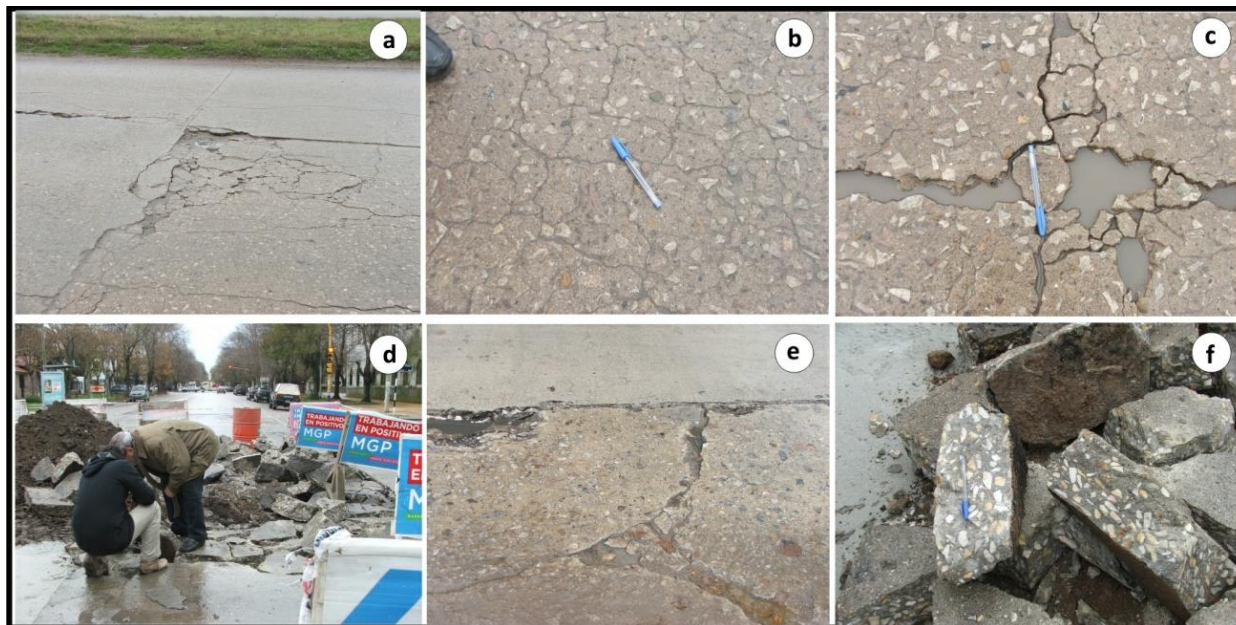
Figura 3. Relevamiento de los pavimentos de Mar del Plata: RP88 (a,b,c) y AvL (d,e,f). a. Losa con fisuras, desprendimientos y erosión de juntas. b. Patrón de fisuras tipo “mapa”. c. Desprendimiento de material y grietas con encharcamiento. d. Fragmentos de losa del tramo removido. e. Desarrollo de fisuras (mayores a 1 cm) y erosión en juntas (bache) en un tramo de losa en servicio. f. Losas removidas.
