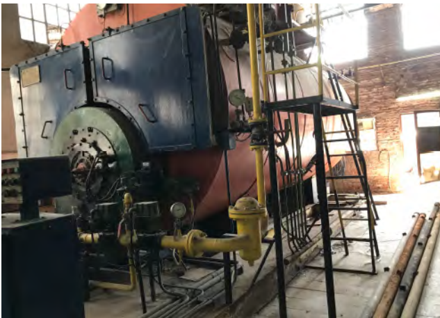
Ilustración 14: Sector calderas. Fotografía propia.
