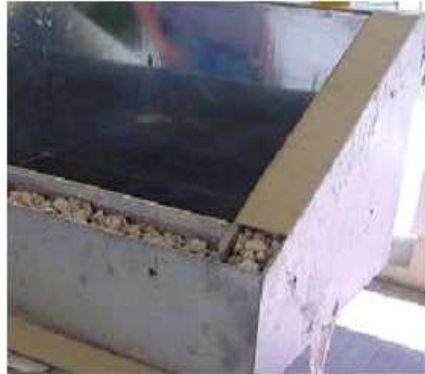
Figura 4: Ejecución de caja interior. Relleno de frente lateral con pomeca puzolánica y colocación de cubiertas captadoras y reflectivas.
