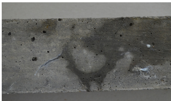
Fotografía 5: Geles y fisuración características de las RAS observados en probetas de hormigón reciclado.
