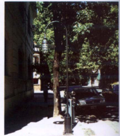
Figura 6. Luminaria complementaria a 3,5mts de altura.
